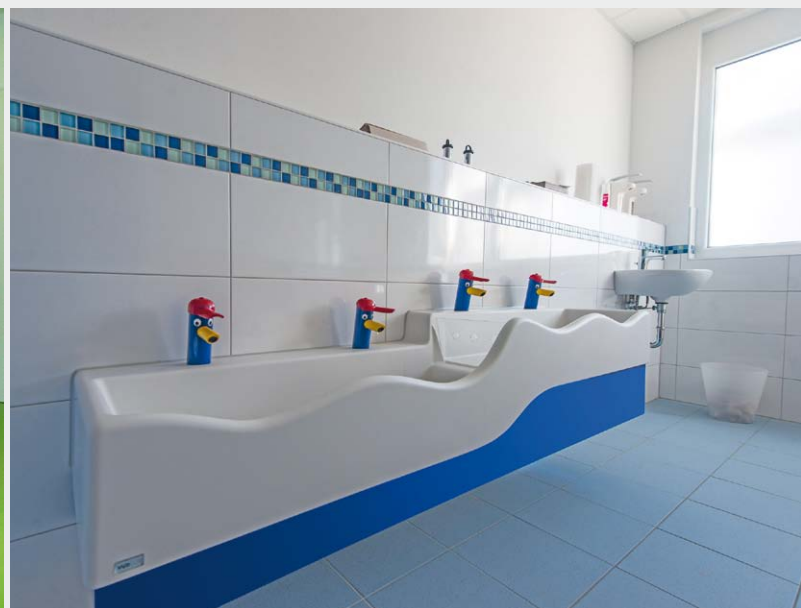
Sanitärraum in neuer Kindertagesstätte
